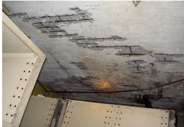
Gambar 3. Pengelupasan selimut beton dan tulangan berkarat pada pelat
