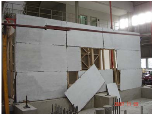
Gambar 5. Kerusakan pada panel papan semen
