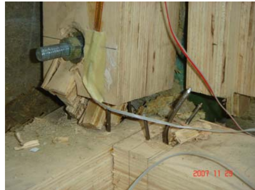
Gambar 6. Kerusakan pada panel papan semen
